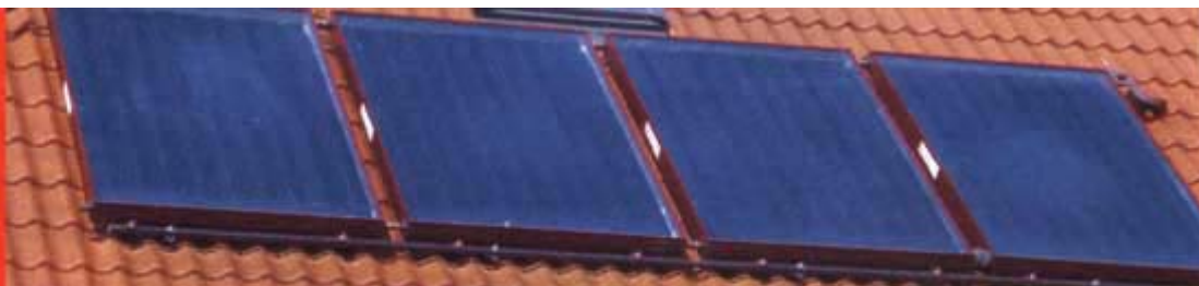
Neun Quadratmeter Sonnenkollektoren für die Warmwasserbereitung sind auf der Südost-Dachfläche installiert.
