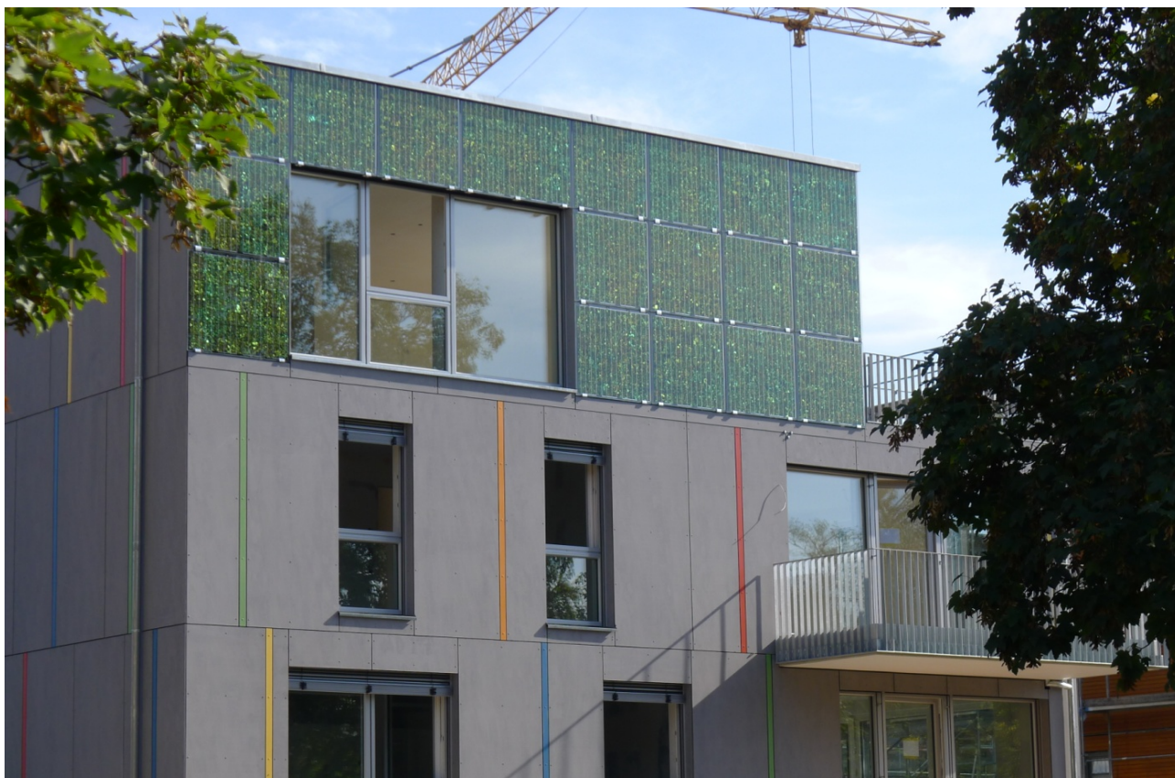
Die Südwestseite mit der gebäudeintegrierten Photovoltaik (GiPV)
