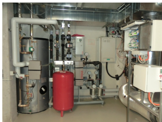
Übergänge Fernwärme und Pufferspeicher
